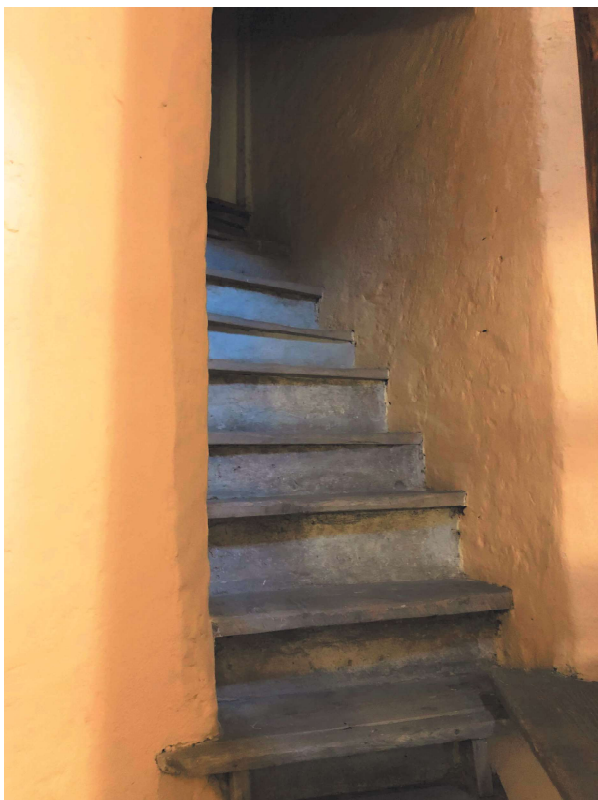
Schody na wieżę główną (stopnie do wymiany)
