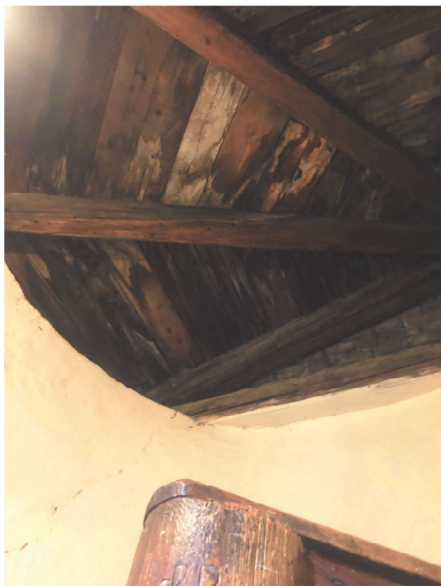
Zniszczona konstrukcja zadaszenia wieżyczek do wymiany
