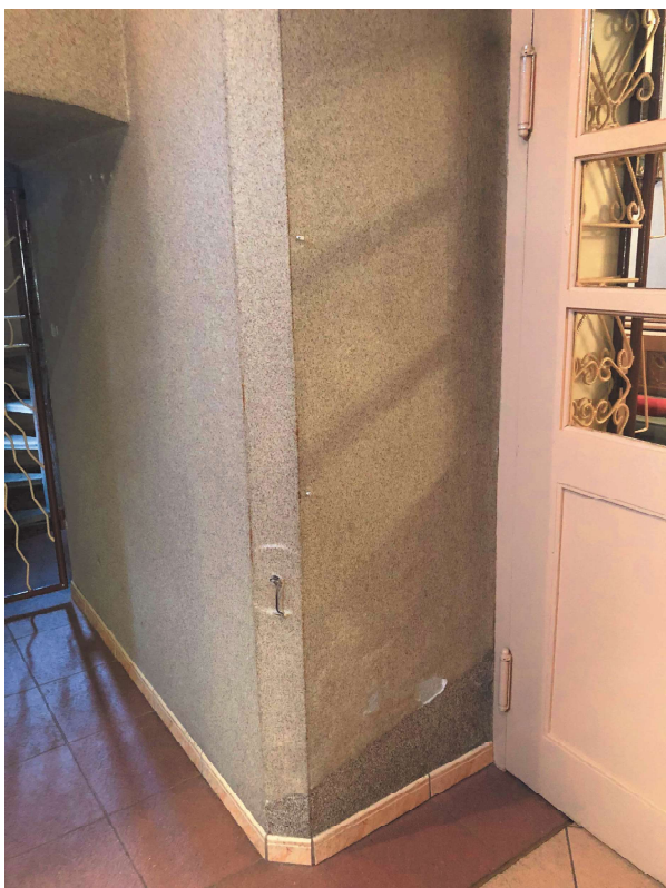
Zniszczony tynk mozaikowy w przedsionku kościoła
