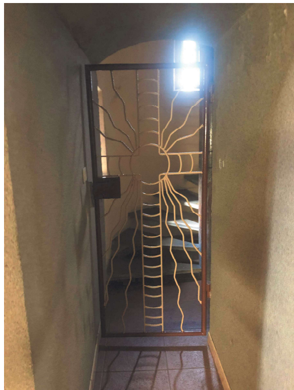
krata przy wejściu do klatek na chór wnętrza kościoła (do wymiany)
